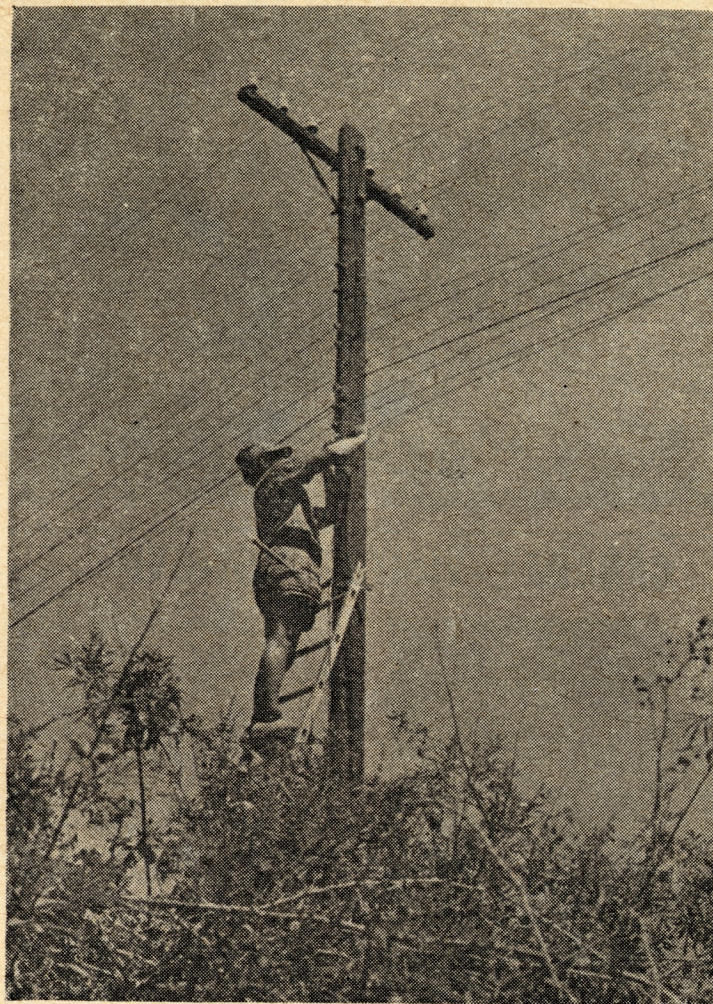
● Ledningynetted er saarbart, men kan hurtigt repareres
